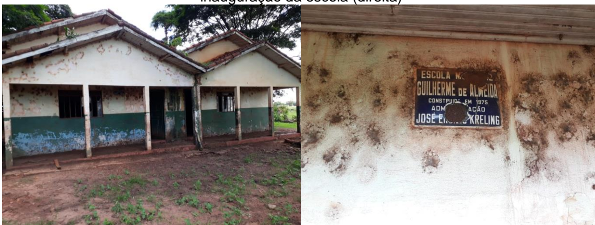
Figura 14 - Estado atual da Escola Municipal Guilherme de Almeida (esquerda) e placa de inauguração da escola (direita)
